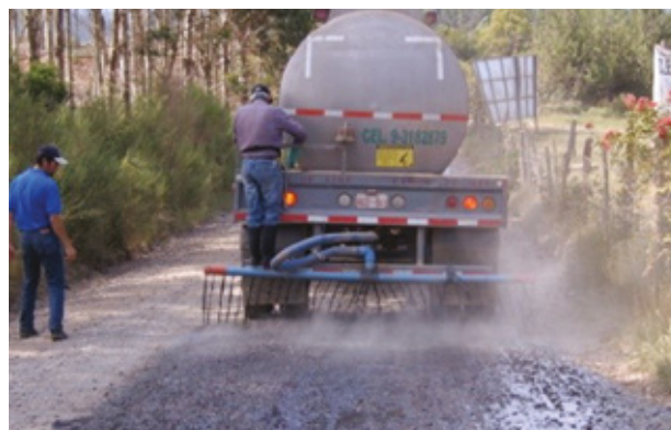
Foto N° 12. Riego superficial de Cloruro de Calcio en la región de Bío Bío Resultados Obtenidos
