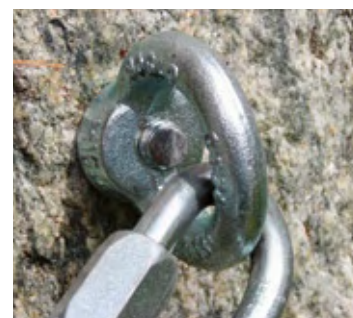
Fig. 65 Bon ancrage des chaînes
