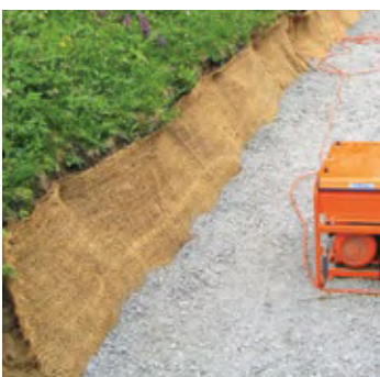
Fig. 76 Les nattes de jute protègent le talus pendant les travaux contre l'érosion
