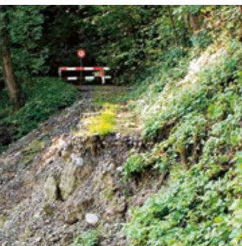
Fig. 92 Glissement de terrain
