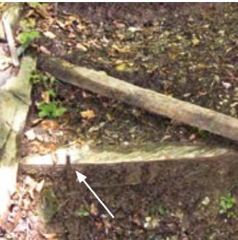
Fig. 86 Dépassement d'un fer d'armature
