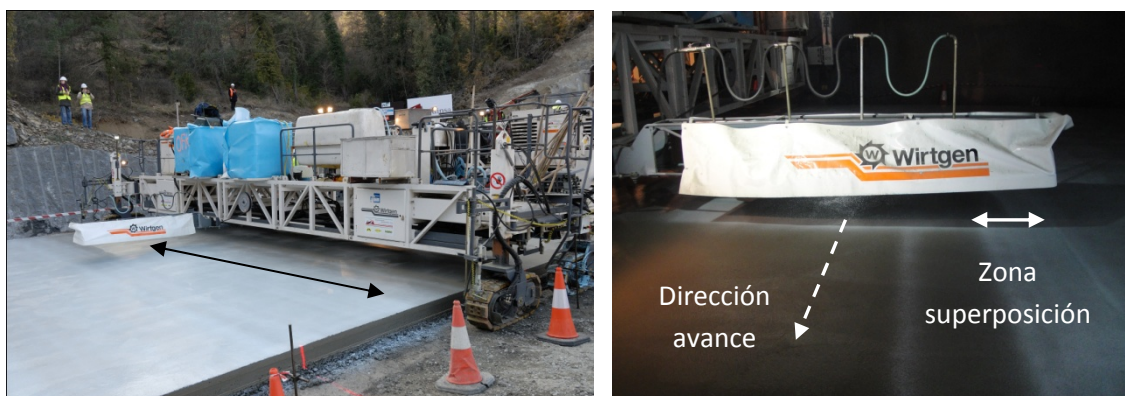
Figura 3.21.- Carro para la aplicación del inhibidor de fraguado y primer líquido de curado: a) Vista general en zona abierta y b) detalle del extendido en túnel
