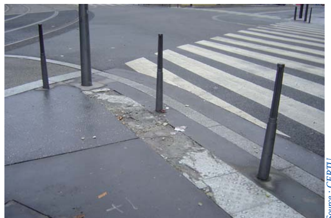
Exemple de détérioration d'une BEV.
