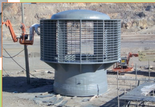
Torre de captación de agua para emisario submarino de refrigeración DN3500
