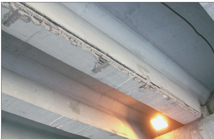
FIGURA 77. EJEMPLO DE DAÑOS
