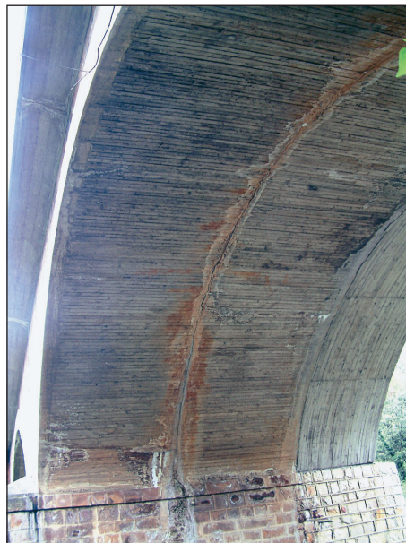
FIGURA 2. EJEMPLO DE DAÑO
