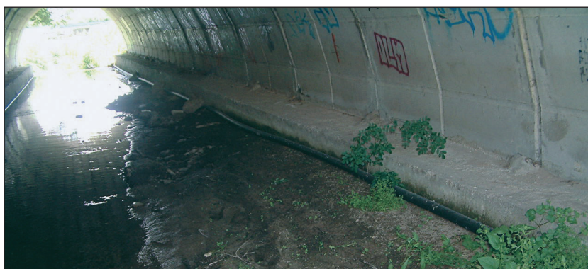
FIGURA 64. DAÑOS EN CAUCES
