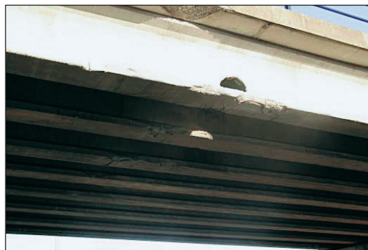
FIGURA 30. ROTURA DE VIGA POR IMPACTO
