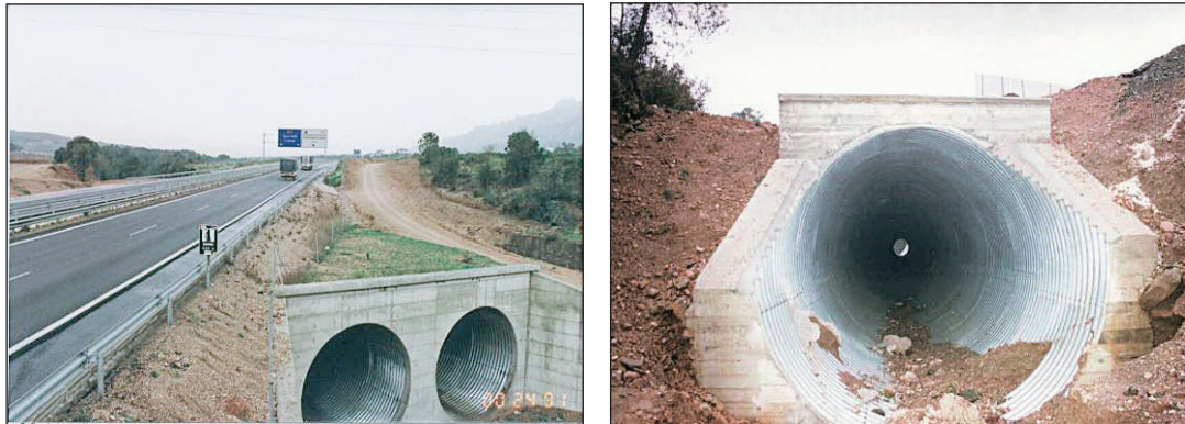
FIGURAS 12 Y 13. TUBOS
