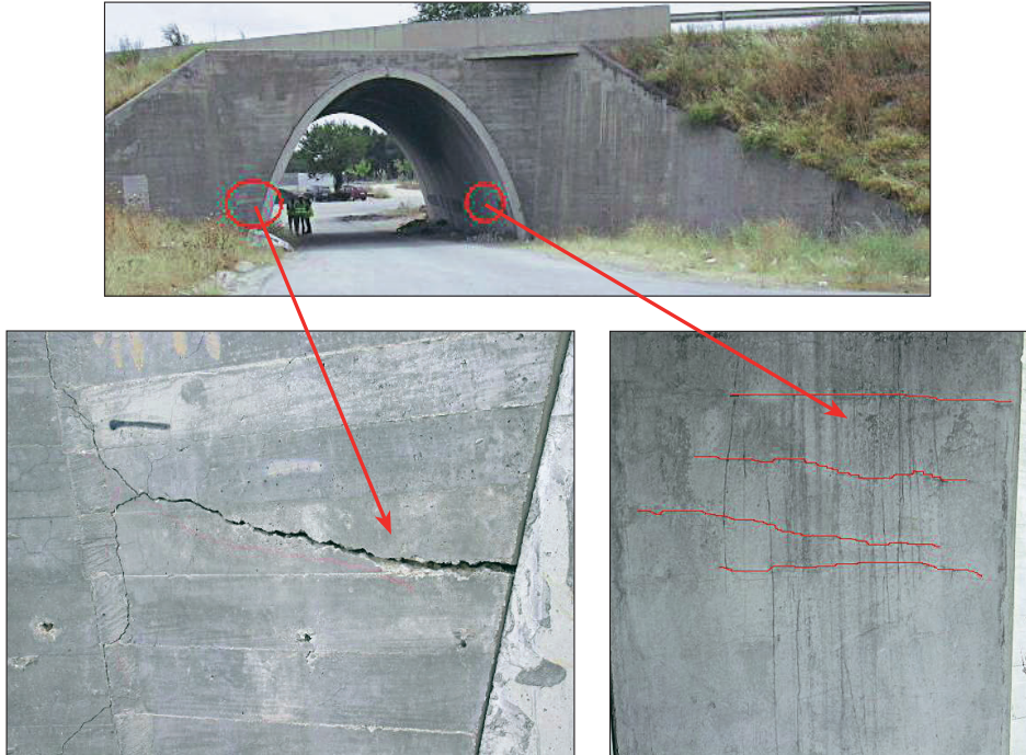
FIGURAS 111, 112 Y 113. FICHA DE DAÑOS
