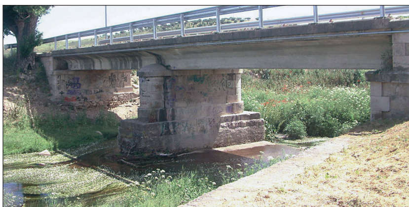
FIGURA 65. DAÑOS EN CAUCES
