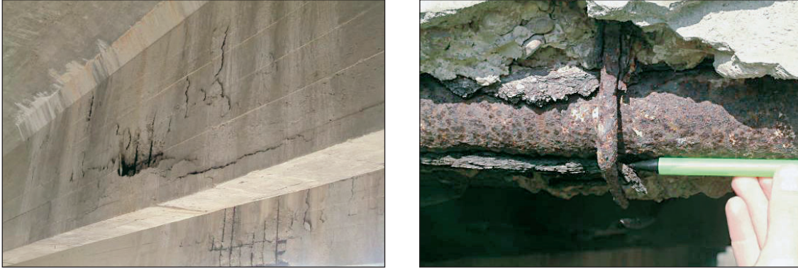
FIGURAS 31 Y 32. CORROSIÓN DE ARMADURAS EN VIGAS (FOTOGRAFÍA IZQUIERDA) Y DETALLE DE CORROSIÓN DE ARMADURAS (FOTOGRAFÍA DERECHA)
