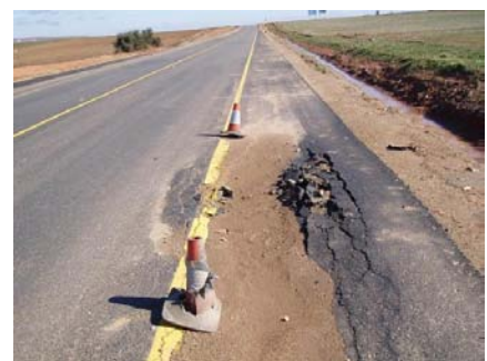
Fotos 4 y 5. Suelos muy plásticos, empleados en la realización de un fallido suelocemento in situ
