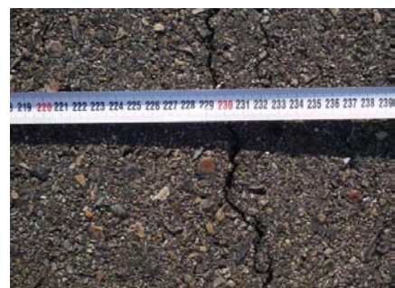
Fotos 21 y 22. Fisuras aparecidas por falta de solape en la construcción
