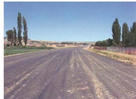
Fotos 2 y 3. Perspectiva de dos suelocementos realizados in situ, curados y terminados
