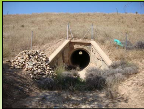
PASO Nº 18 Tubo CARRETERA N-232 CASTEJÓN-TUDELA. AÑO 2008
