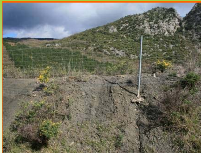
Deficiencias en el vallado
