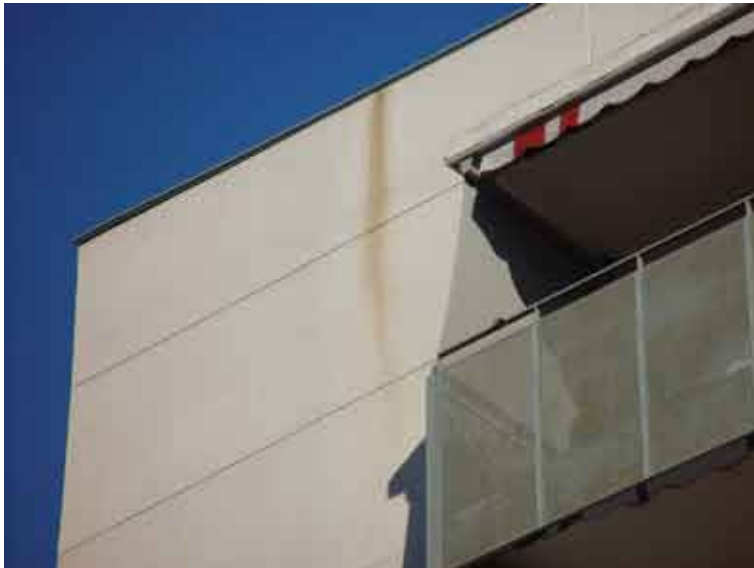
13. Ensuciamiento de la fachada por esorrentía.
