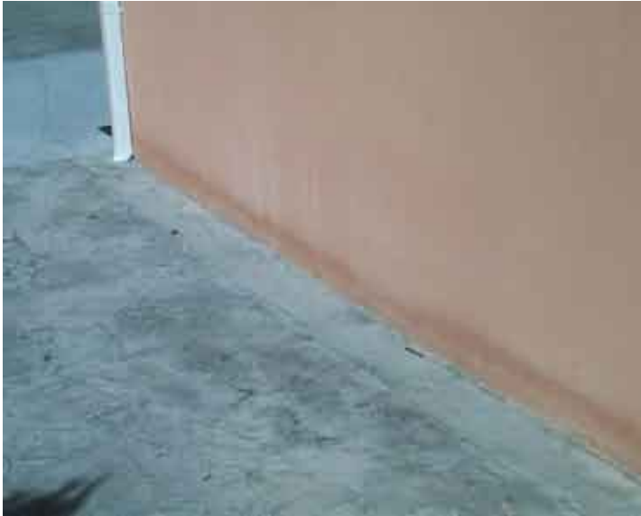
15. Patología de zócalo.
