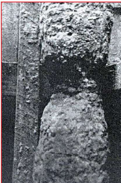
Fig. 27. Estrangulamiento en la sección de un pilote. (Hobbs, N.B., 1957).
