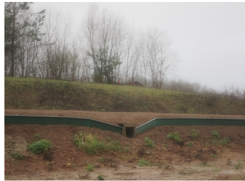
Photo 35 : Collecteur en plastique recyclé, matériau prometteur mais très fragile en l'état actuel (Source : © A. Morand, Cerema Est)
