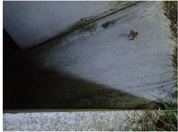
Photos 46 : Batrachoduc de Gaumont : la pente est un peu « raide » au point que le Parc naturel régional de Lorraine, l'un des porteurs du projet, a dû poser du géotextile sur les traversées les plus fréquentées par les amphibiens (Source : © A. Morand, Cerema Est)
