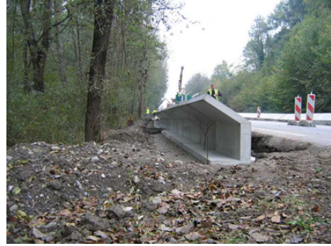
Photo 33 : Collecteur préfabriqué en béton avec corniche anti-escalade ou bavolet conséquent « en prévision » de la Rainette arboricole sur le site du Cheylas (Source : © H. Coffre, LPO 38)
