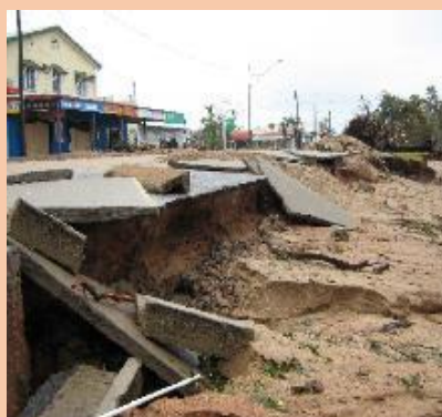
Daños en la carretera
