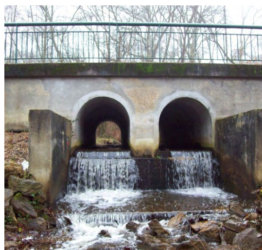
Illustration 4 : Vue de l'ouvrage aval avant reconstruction – Source : CD 33.
