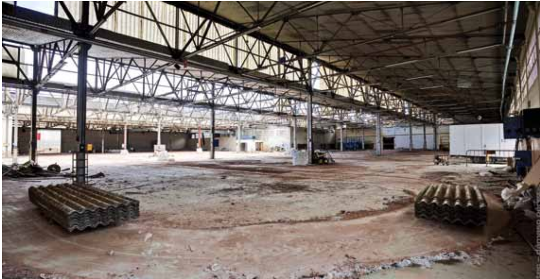
Figura 2. Entorno con amianto
